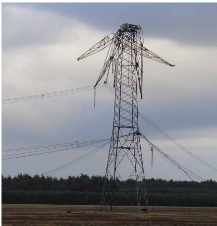
Sturmschaden durch den Orkan Kyrill im Jahr 2007
